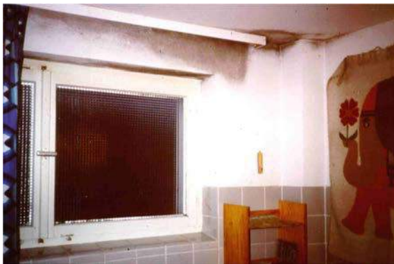
Foto 34: Schimmel in Wohnräumen – ein vermeidbares Problem. Quelle: ebök
