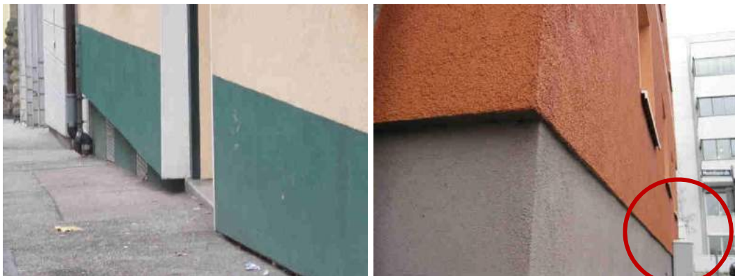
Foto 28 & 29: Die Dämmung der Außenwand ragt in den Straßenraum hinein, im rechten Bild an der einen Giebelwand deutlich schwächer als an der anderen. Die Dämmung steht auch in Konflikt mit dem Telefonverteiler (rechts unten im Bild) sowie dem (im Bild nicht sichtbaren) engen Bürgersteig. Es wäre möglich gewesen, die Dämmung im Bereich der Laufwege und des Verteilers abzusetzen und so große Teile der Wand stärker zu dämmen. Quelle: ebök
